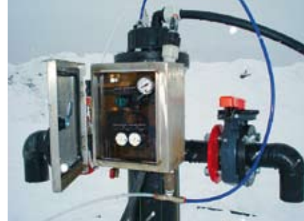
Figura 10 - Pozzo centrale del campo prove, allestito con la centralina di comando degli eiettori
