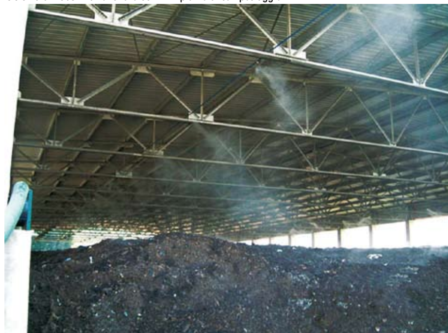
Sistema di nebulizzazione Idrotech in impianto di compostaggio
