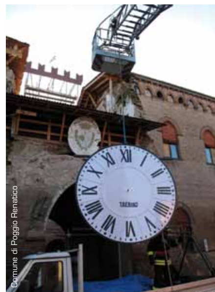
Posa del nuovo orologio del castello Lambertini, sede del comune di Poggio Renatico (FE), sull'impalcatura che ha sostituito la torre distrutta dal sisma (dicembre 2012)
