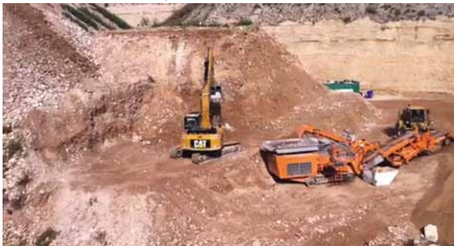
Operazioni di frantumazione e vagliatura all'ex Teges, per la definitiva trasformazione delle macerie in materiale da ripristino ambientale
