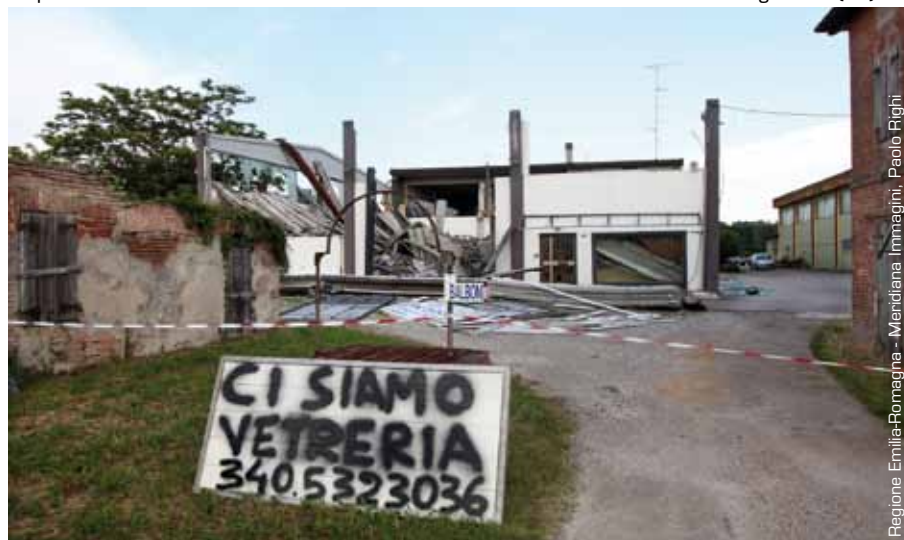
Capannone lesionato della Vetreria Balboni nella Zona industriale di Sant'Agostino (FE)
