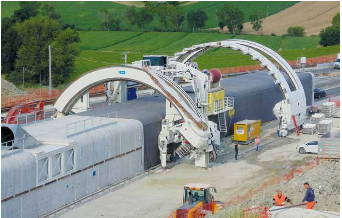
Figura 7 - Galleria Montedomini: le due macchine utilizzate per l'ampliamento in sede in presenza di traffico
