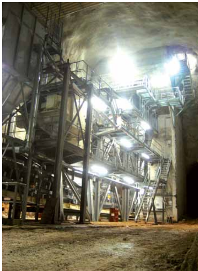
Vista complessiva dell'impianto di frantumazione
