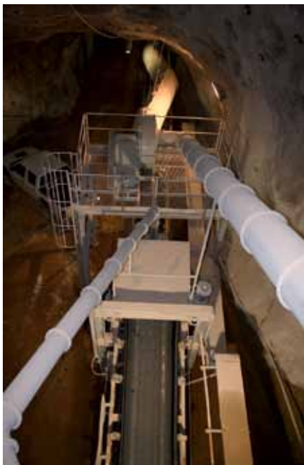
Particolare dell'impianto di aspirazione polveri
